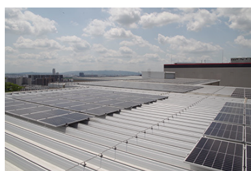
三期棟に設置された太陽光発電
