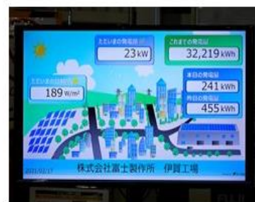
発電状況を表示するモニターを設置
