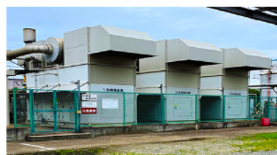
3台の自家発電機のうち、 非常時に備えて待機している1台を活用
