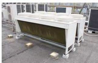
冷凍ショーケースの室外機
