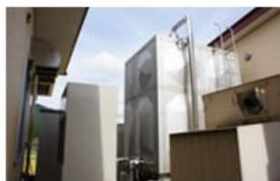
エコキュート 室外機と貯湯槽
