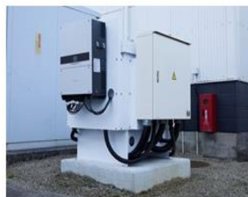
パワーコンディショナー (関西電力資産)
