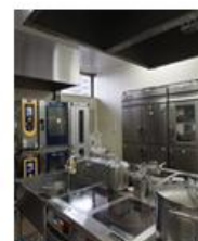
電化厨房機器
