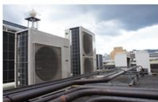
空調機の室外機
