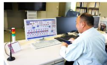
中央監視装置で送水状況や電力使用量を監視
