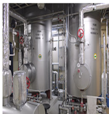
水温を55度で維持できる貯湯槽(2基)
