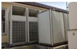
エコアイス 室外機と蓄熱槽
