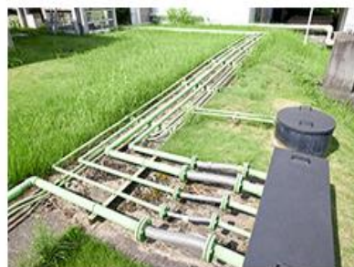
非常用発電機用石油燃料の 備蓄スペース(地下)と配管
