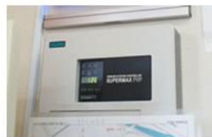
デマンドコントローラー
