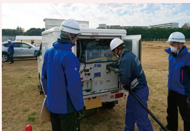
移動電源車への給油訓練
